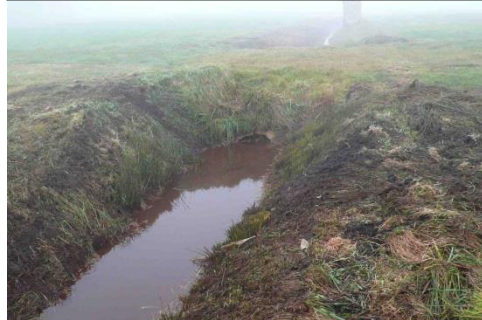
Allerbeeke Oberlauf-Rückstau aufgrund zu kleinen Rohrdurchlasses
