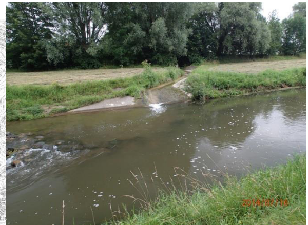
↑ Die derzeitige Mündung der Lutter in die Leine ist als Betonrutsche ausgebildet, die die bachaufwärtige Wanderung der Aquafauna unterbindet.
