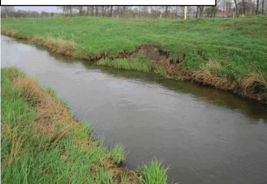
Klosterbach Unterlauf-Uferabbrüche durch Unterspülung
